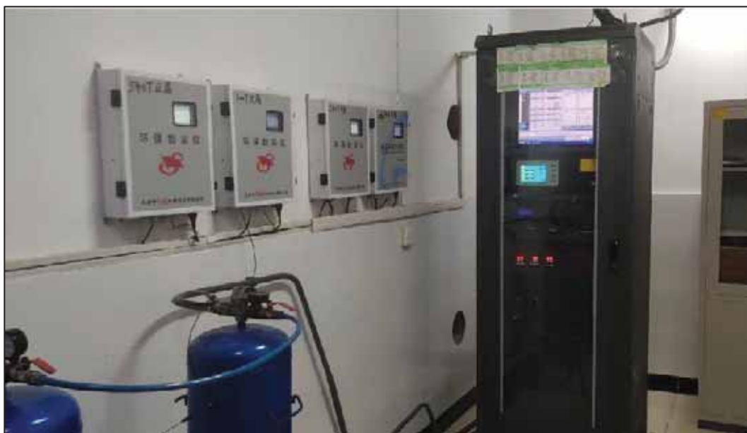
焚烧炉在线监测设施
