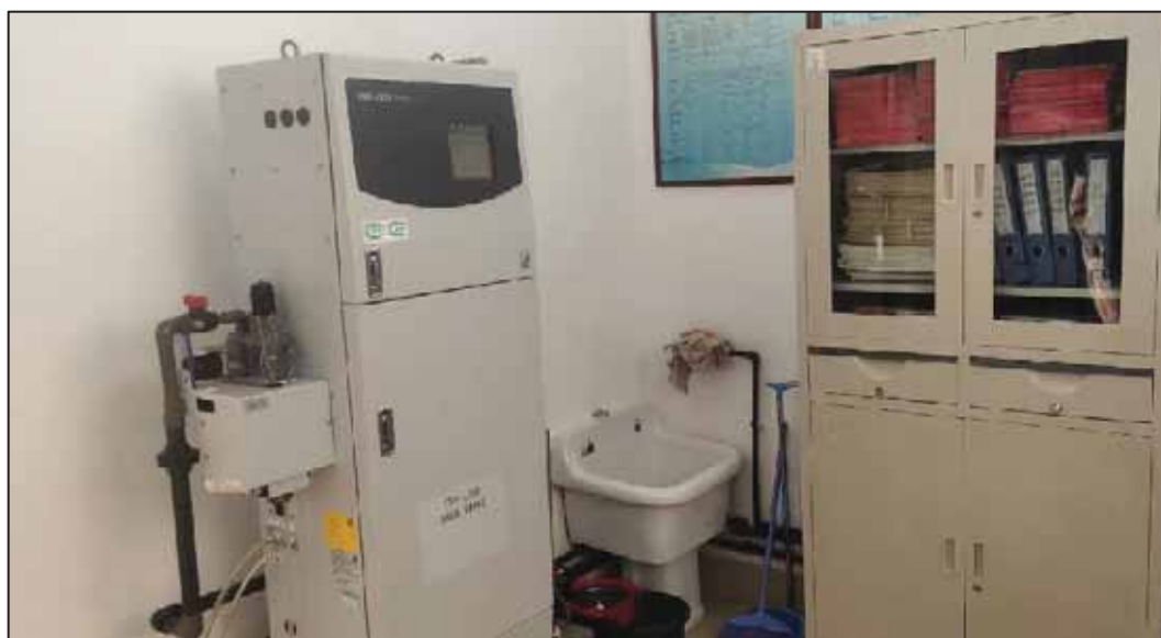
废水总排口在线监测及数据传输设施
