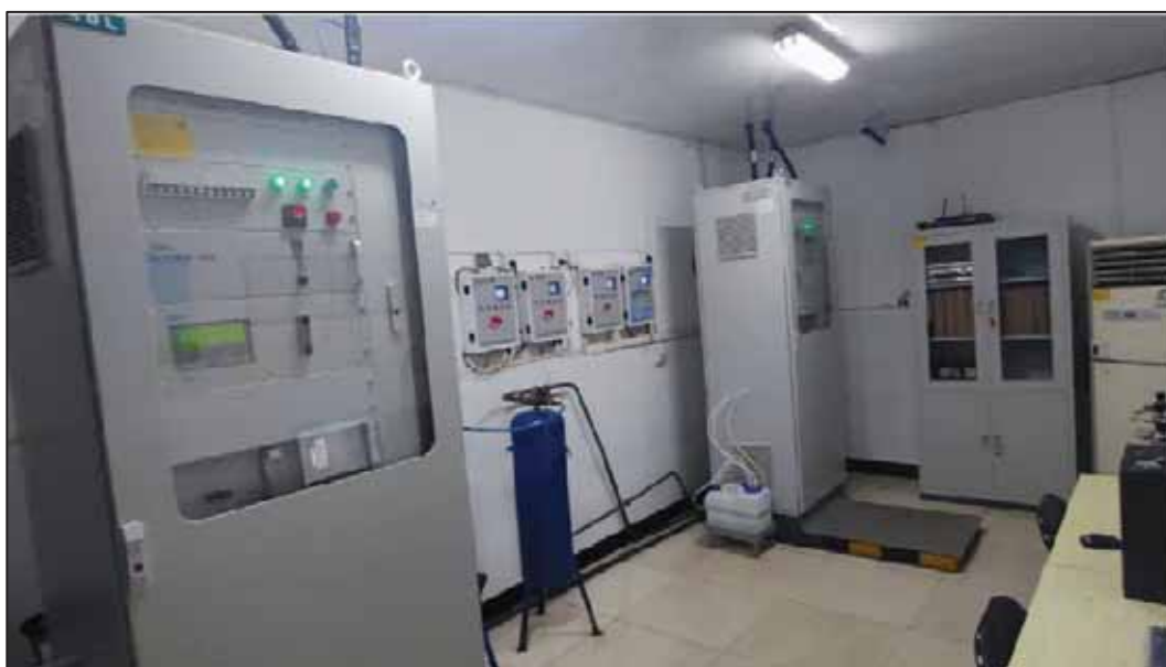
锅炉废气在线监测及数据传输设施
