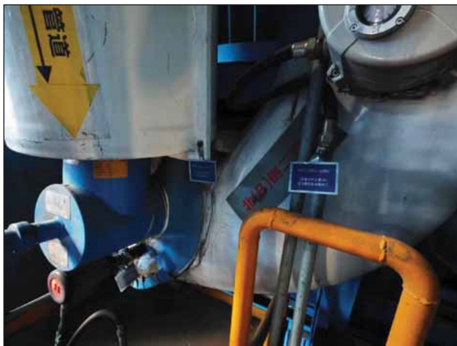
锅炉沼气系统
