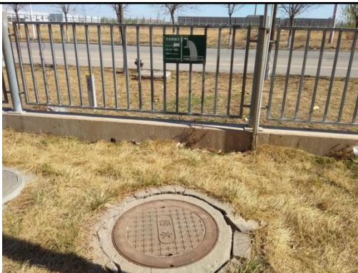
废水总排口 DW001
