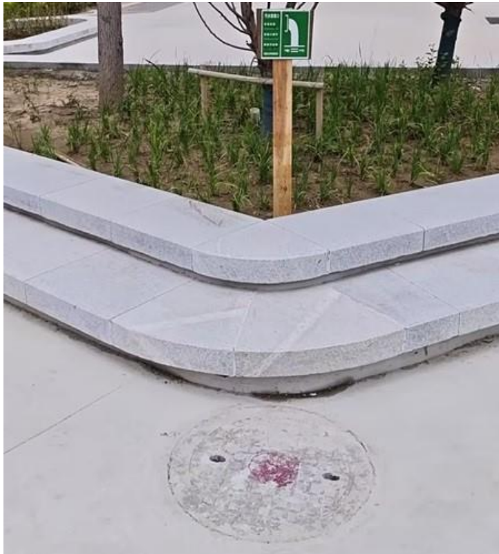
污水总排口 (DW001)
