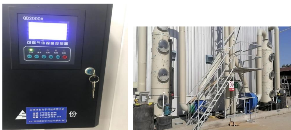
车间有毒气体检测器
