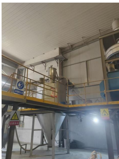
图 4.1-2 混料粉尘收集及治理装置现场图
