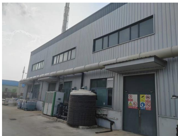
废气收集管道
