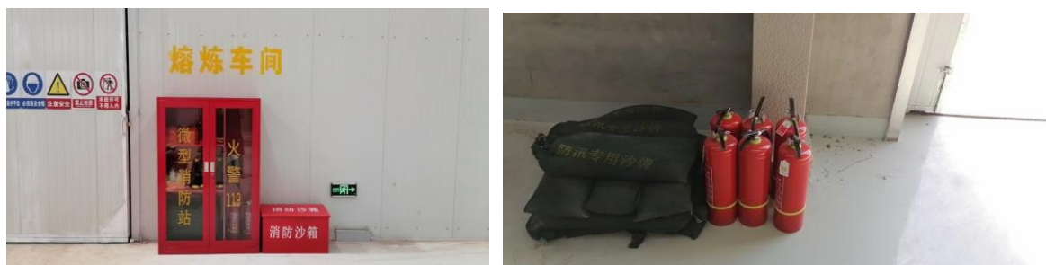
图 4.2-2 车间消防设施
