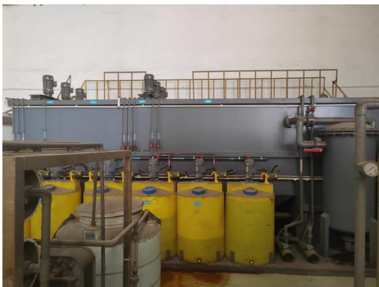
图 4.1-1 废水治理装置现场图
