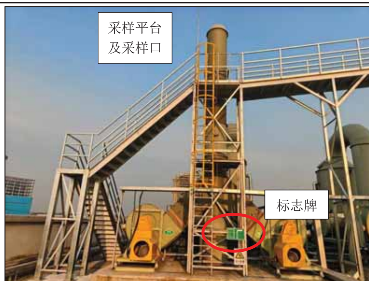
酸性废气排气筒 (DA001)
