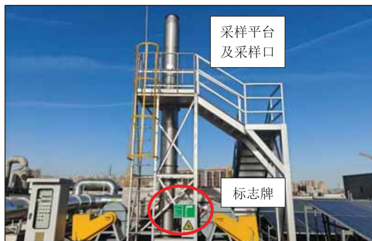
有机废气排气筒 (DA007)
