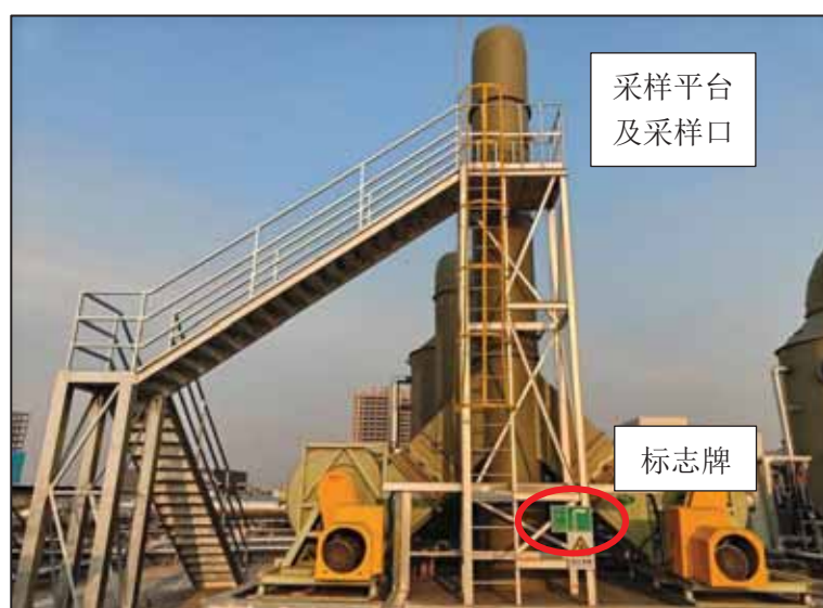
酸性废气排气筒 (DA005)
