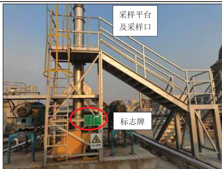
有机废气排气筒 (DA003)
