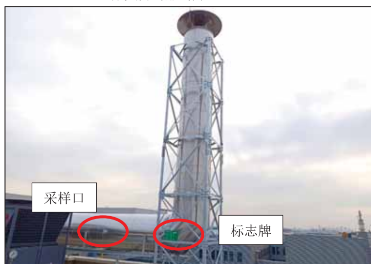
燃气锅炉排气筒 (DA004)
