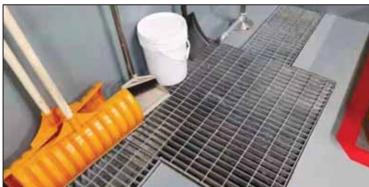
耗材供应车间内泄漏物料收集渠
