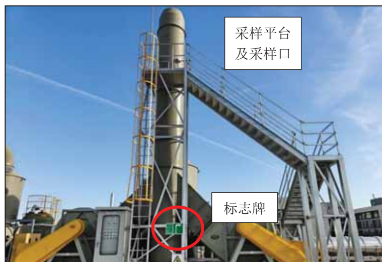
工艺废气排气筒 (DA006)
