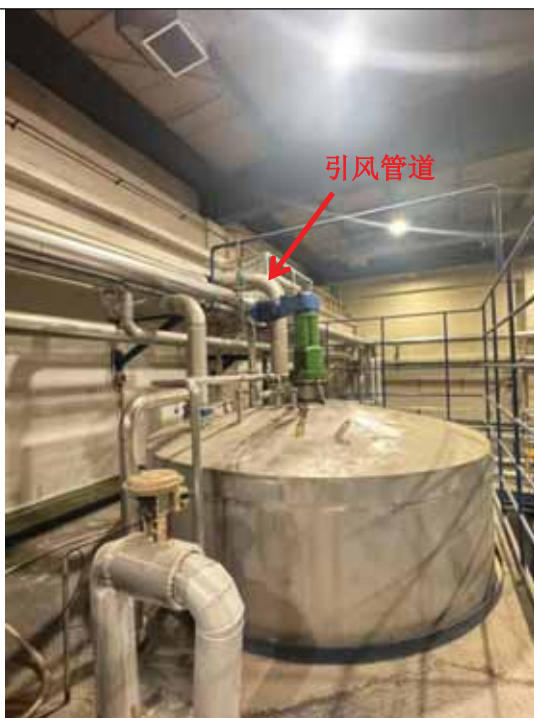
图 2.10-3 灭活罐现场照片
