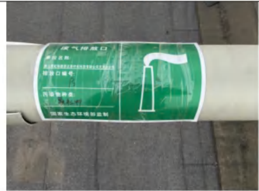
P 2 排气筒标识牌
