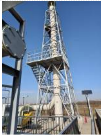
P10（DA008）排气筒及规范化情况
