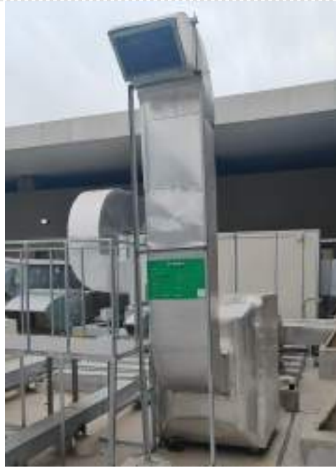
P2 (DA018) 排气筒及规范化情况
