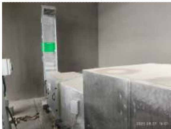
P3 (DA013) 排气筒及规范化情况
