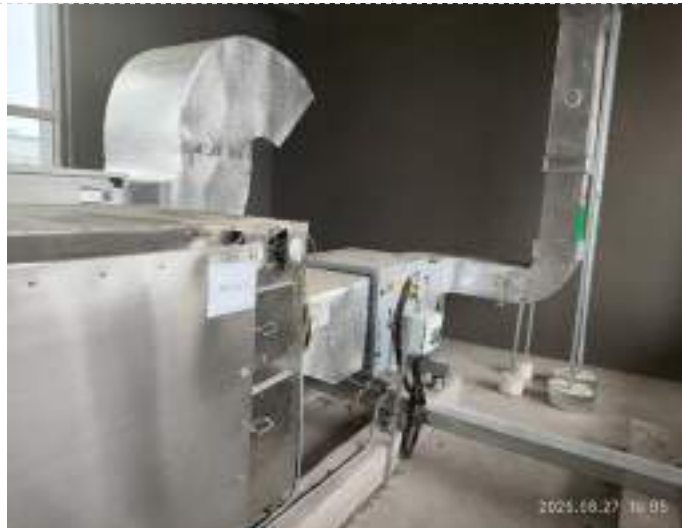
DA028 排气筒及规范化情况
