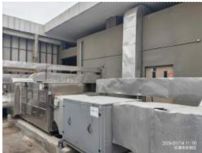
P1 (DA012) 排气筒及规范化情况
