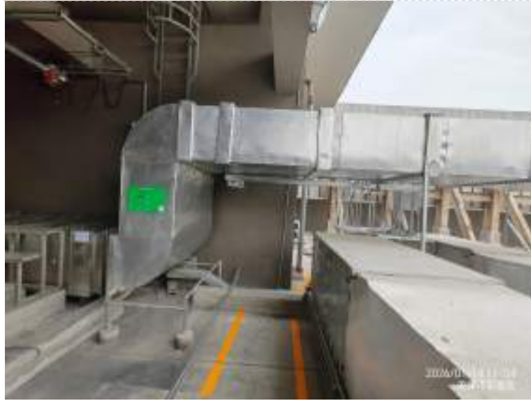
P8 (DA023) 排气筒及规范化情况
