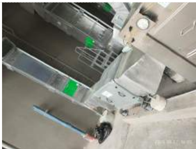
P6 (DA016) 排气筒及规范化情况
