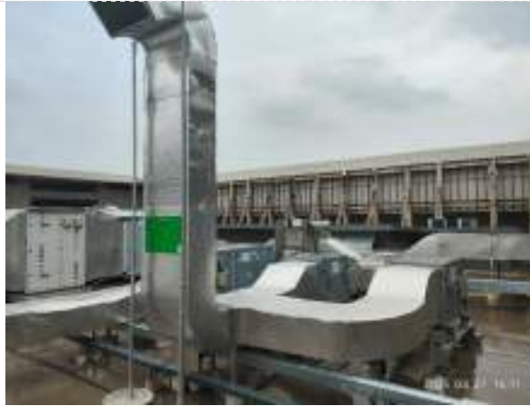
DA029 排气筒及规范化情况
