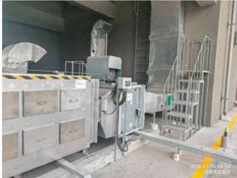
P5 (DA014) 排气筒及规范化情况
