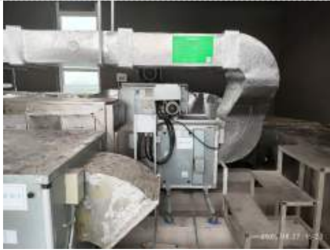
DA027 排气筒及规范化情况
