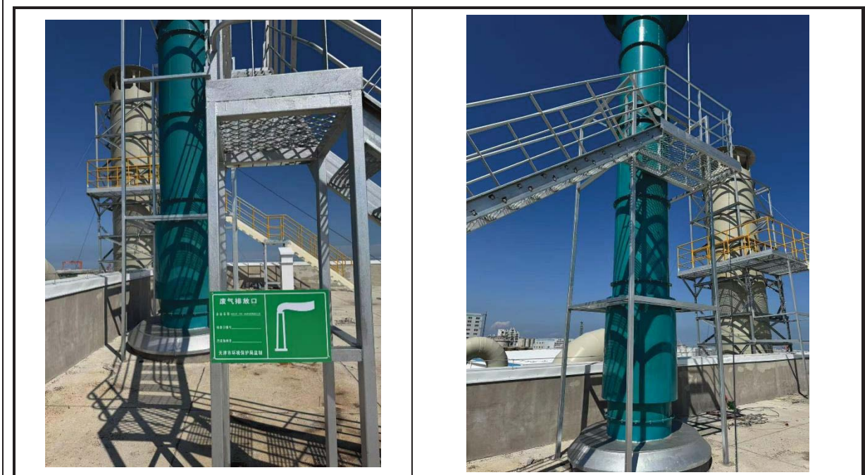
图 3-6 新增 DA029 废气排放口规范化建设情况
