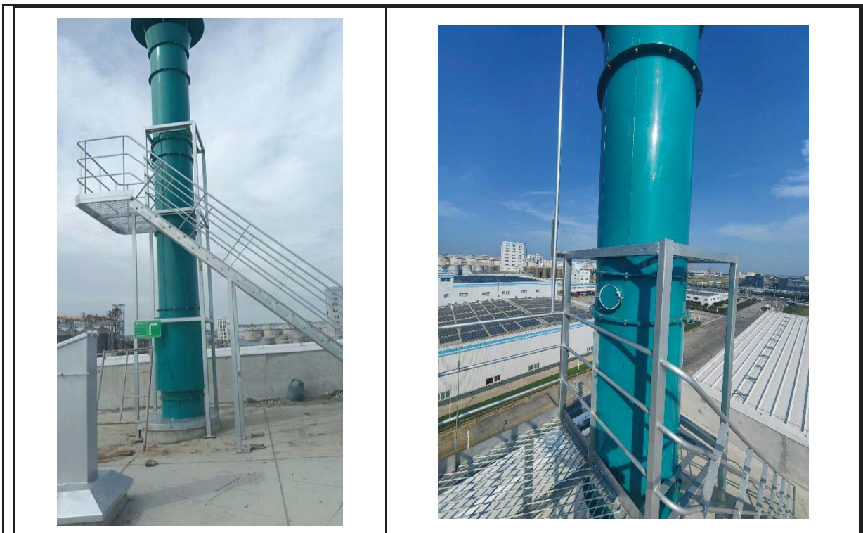
图 3-5 新增 DA028 废气排放口规范化建设情况
