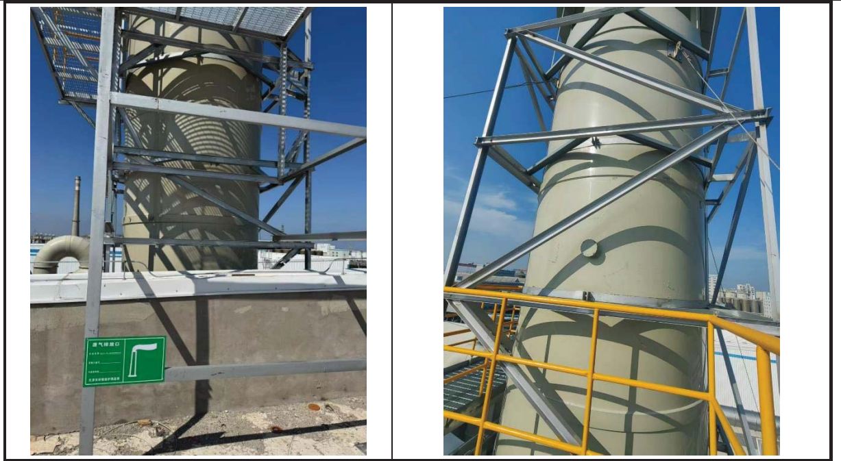
图 3-7 新增 DA030 废气排放口规范化建设情况
