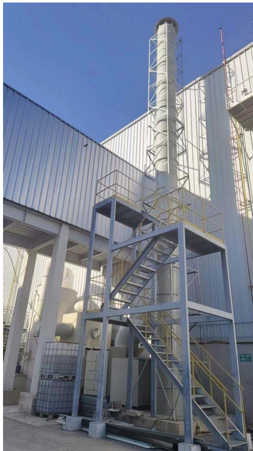
图 3-5 依托的 P4 废气排放口规范化建设情况
