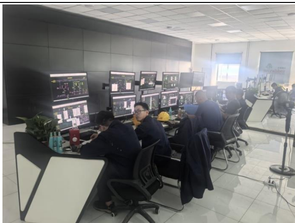
炭黑生产区域 DCS 控制室照片
