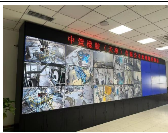
炭黑生产区域视频监控系统
