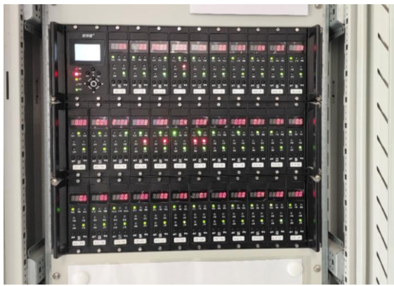
炭黑区域原料油罐区储罐高低位报警装置-控制机柜
