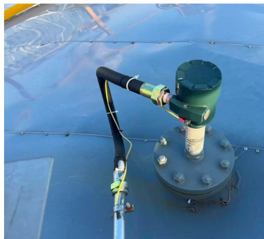
原料油储罐液位计
