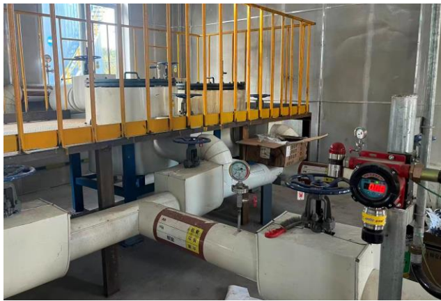
原料油罐区可燃气体检测器
