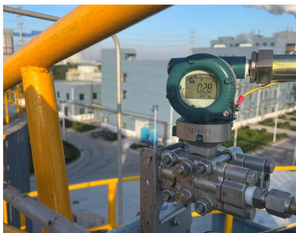
原料油储罐压力表
