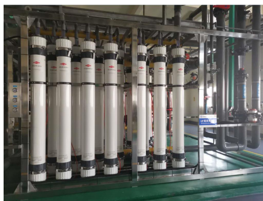
回用水处理系统（UF超滤系统）
