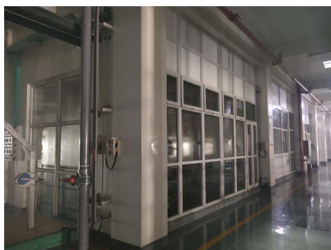
生化反应池组整体封闭
