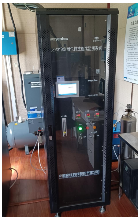
锅炉废气在线监测设备
