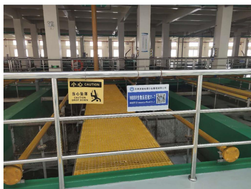
MBBR生化反应池
