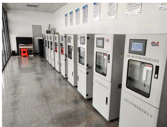
废水总排口在线监测设备
