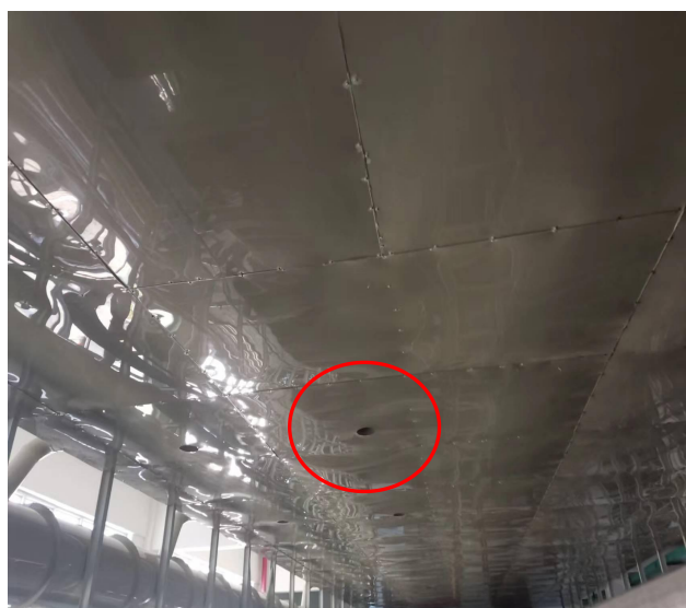
电镀废气顶吸
