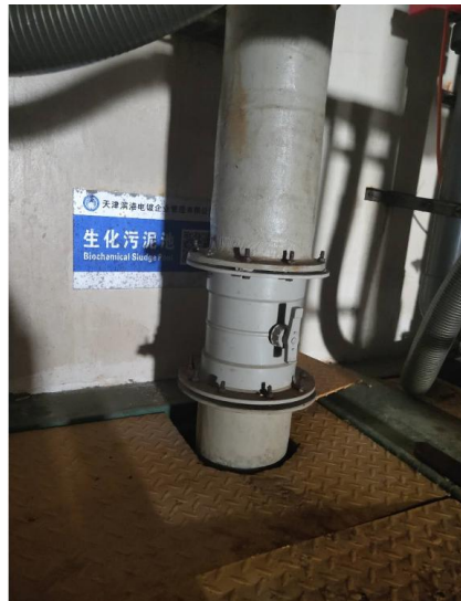
生化污泥池废气密闭收集
