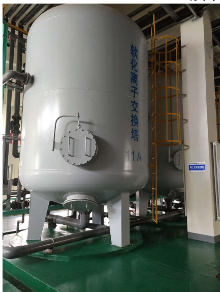
回用水处理系统（离子交换树脂塔）
