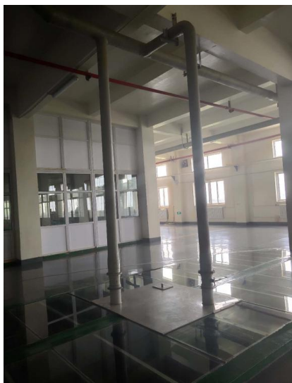
水解酸化池废气密闭收集
