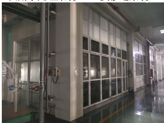
生化预处理系统（已封闭的缺氧池）
