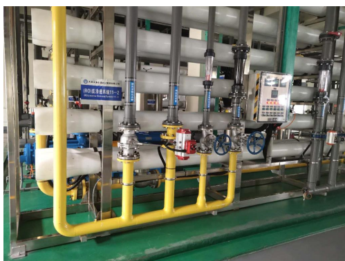
回用水处理系统（RO反渗透系统）
