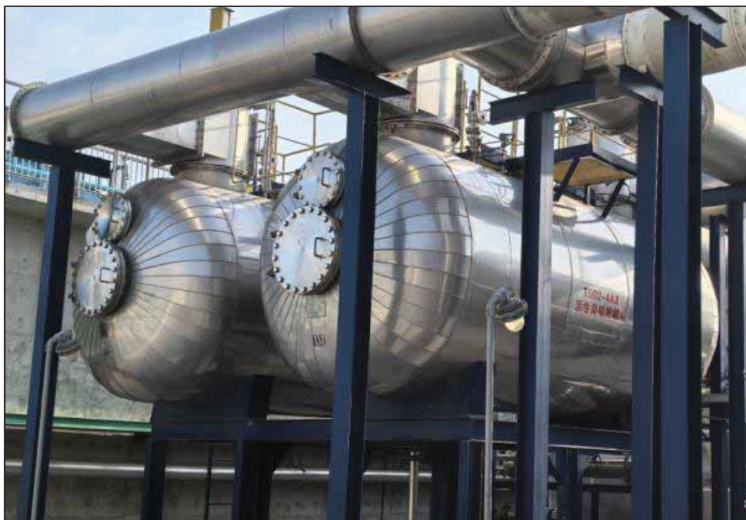
有组织恶臭废气处理设施
