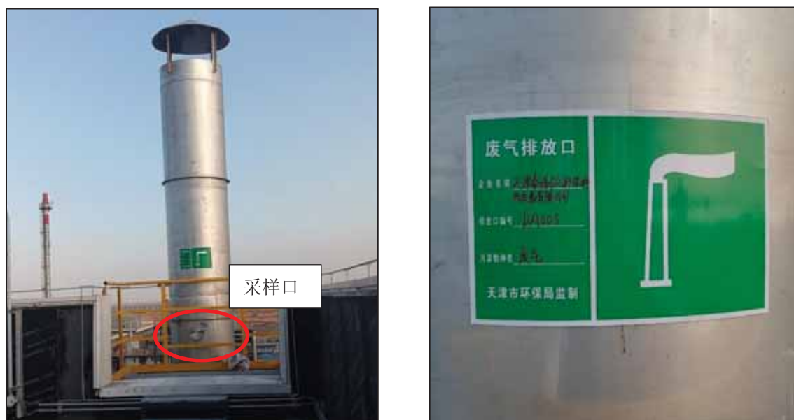
硫酸钠干燥及包装废气排气筒 (DA003)
