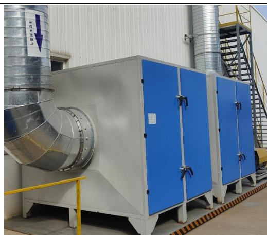
注塑废气二级活性炭处理设施
