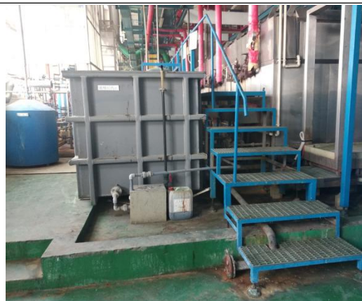
电镀车间地面围堰
