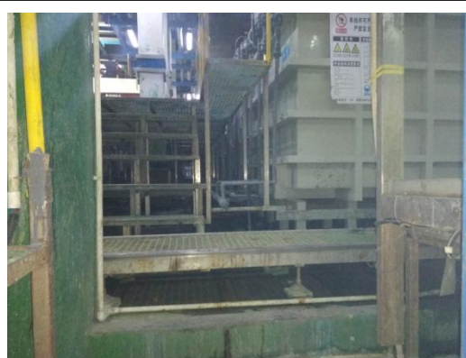
电镀线槽体架空
