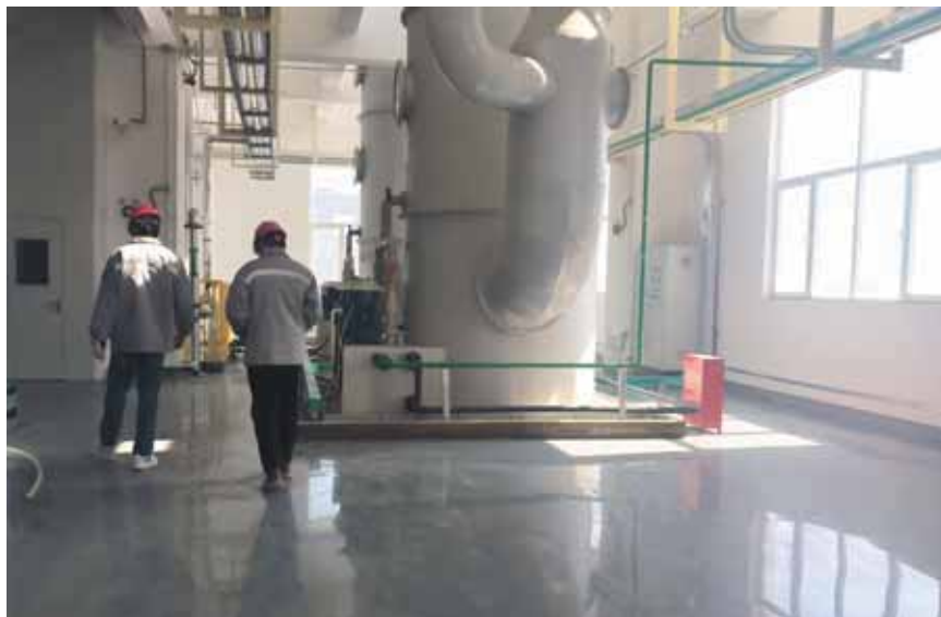
图4.2-1 甲类厂房A内防渗地面
