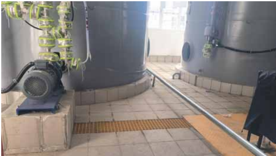
图 4.3-1 产品槽周边围堰和集液沟
