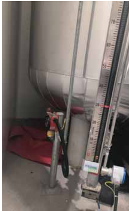
图 4.3-3 甲类厂房 A 三氧化硫中间罐旁边的泄漏检测报警器
