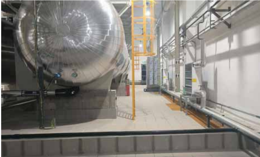
图 4.3-2 三氧化硫储罐周边围堰和集液沟
