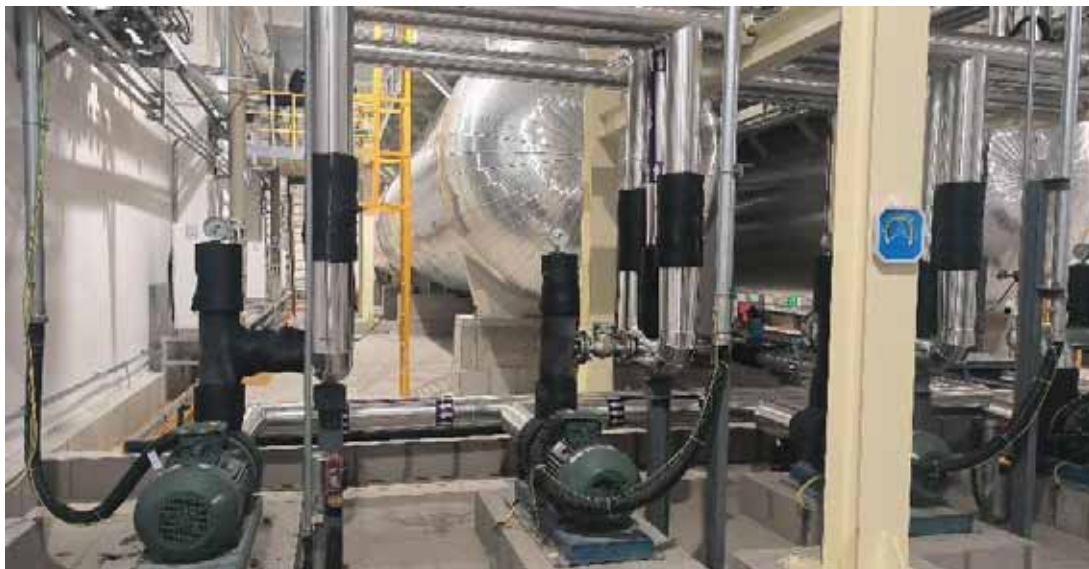
图 4.3-4 三氧化硫储罐旁边的泄漏检测报警器
