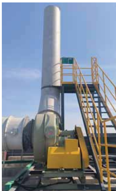
图 4.1-2 酸性废气排气筒（DA006）
