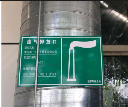
排气筒 P1 环保标识牌
