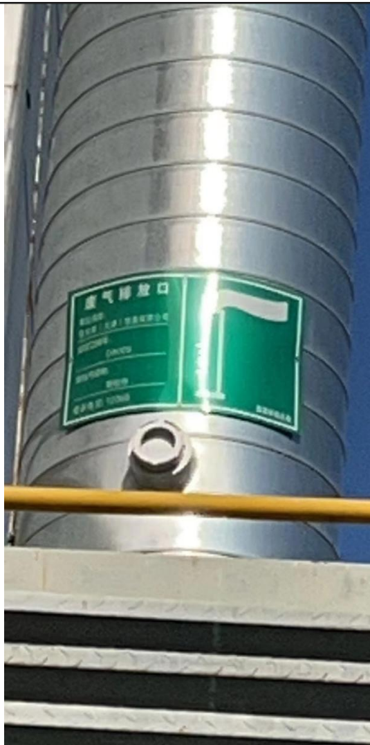
排气筒 P5 标识牌
