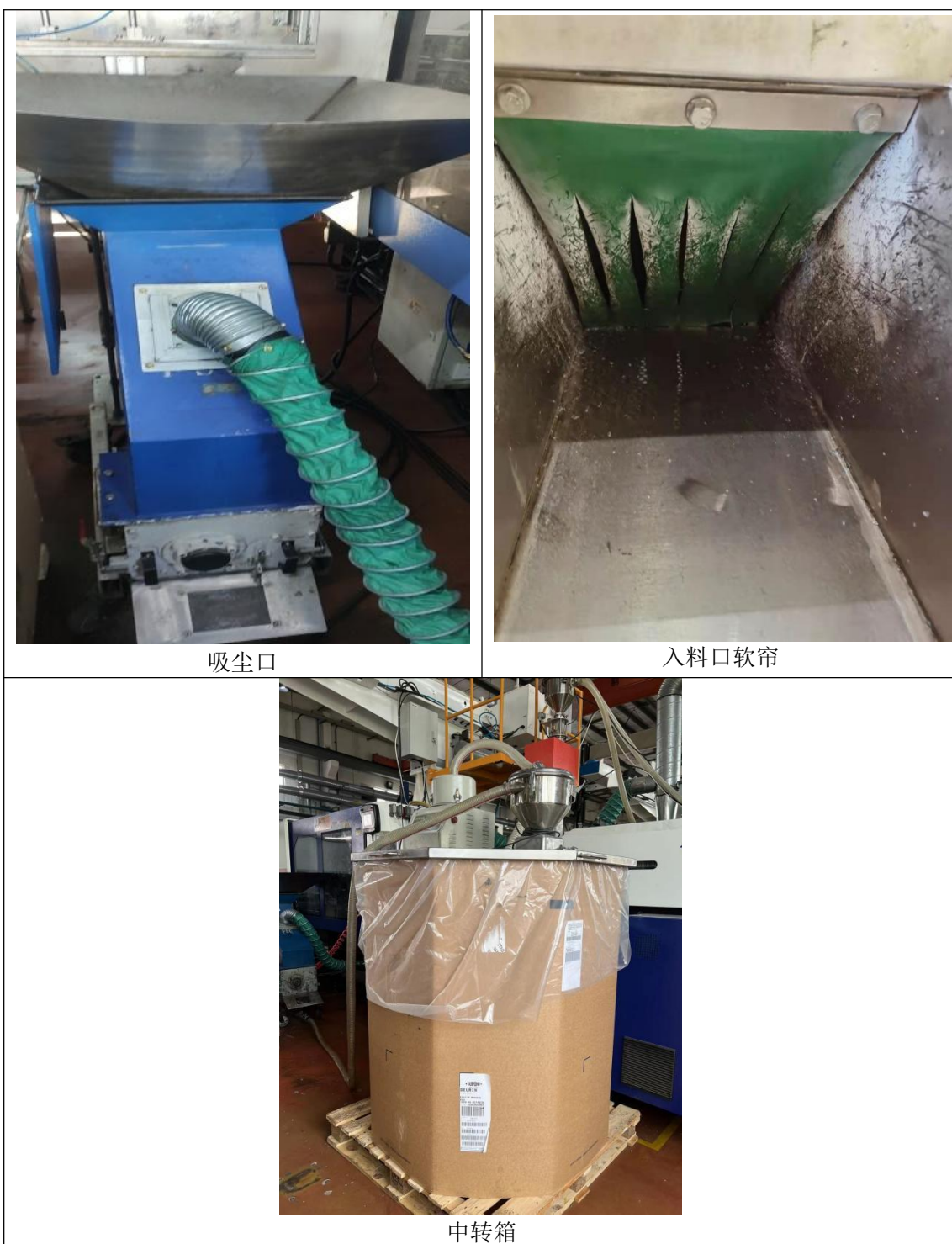
图 7-2 现有工程粉碎工序废气收集装置
