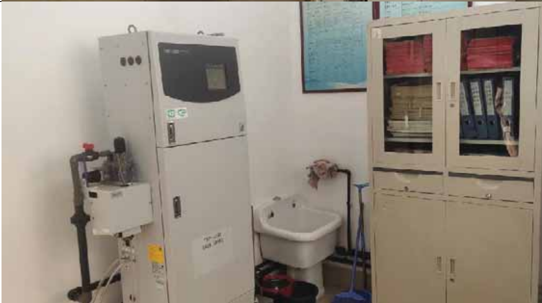
废水总排口在线监测及数据传输
