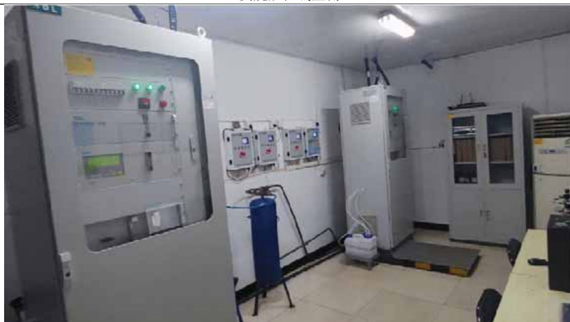
锅炉废气在线监测及数据传输
