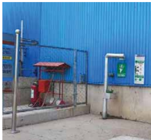
消防设施、洗眼器
