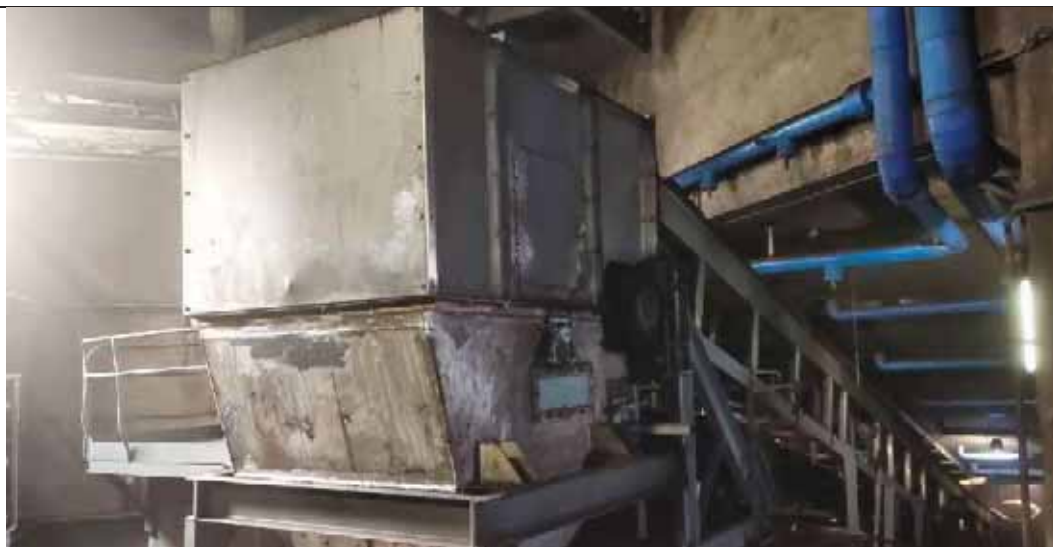
密闭输煤及无动力除尘器
