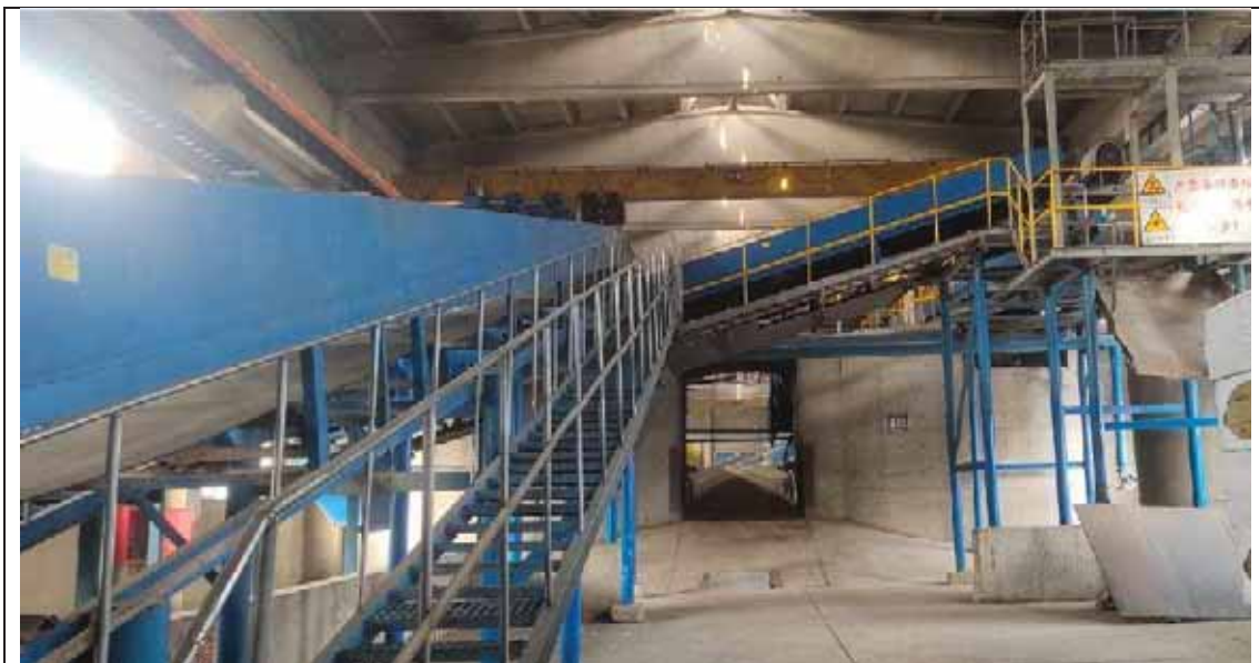
皮带输送机和重渣沉淀池
