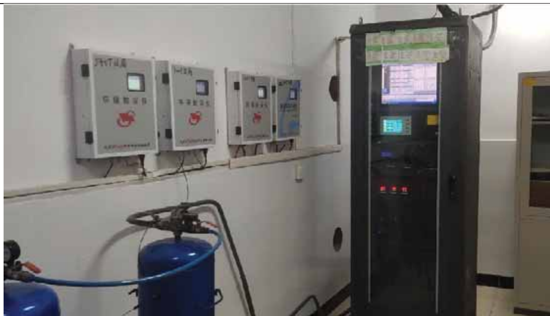
焚烧炉在线监测
