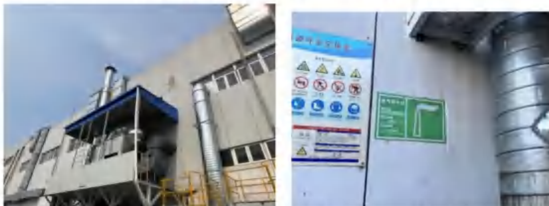
图 2.6-2 压铸脱模工序排气筒（DA002）及其标识牌
