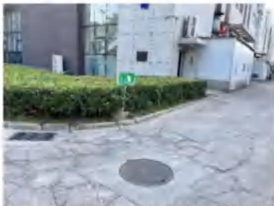
图2.6-6 厂区废水总排口规范化建设情况
