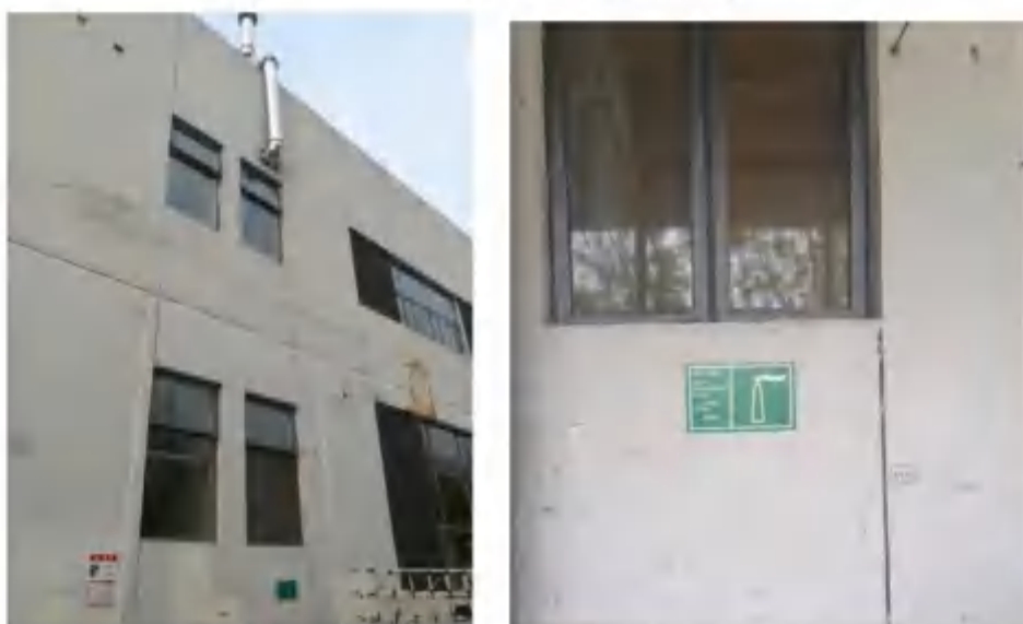
图2.6-5 焊接烟尘排气筒（DA005）及其标识牌
