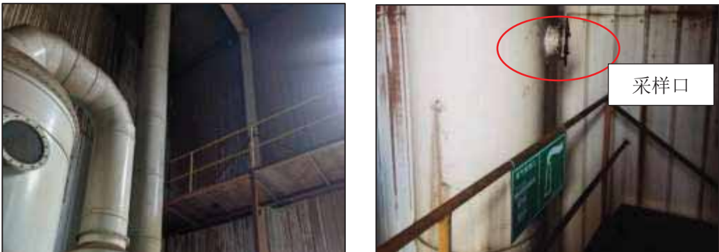
镀锡车间酸洗废气排气筒（DA001）
