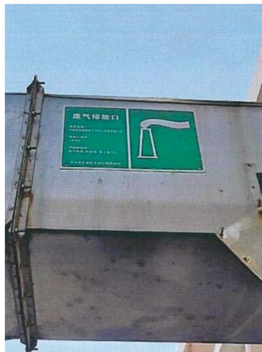
排气筒 DA003 标识牌
