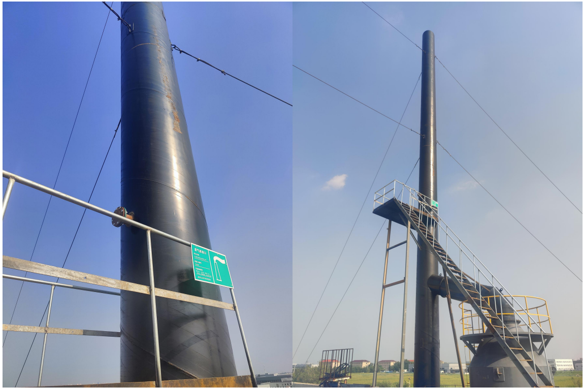
图 3 废气排气筒及规范化情况
