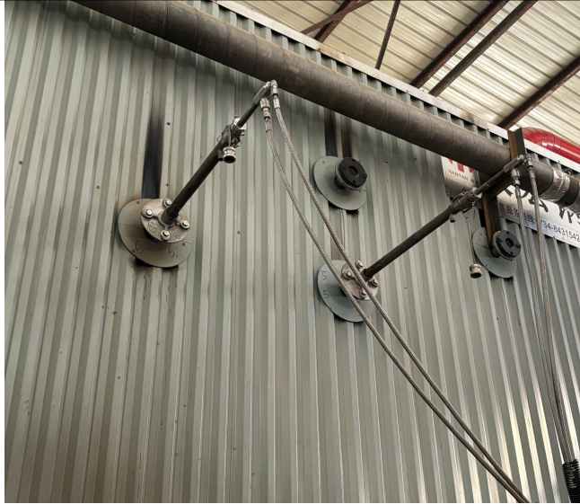
脱硝设施 2（炉内脱硝）
